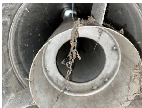
Open onderzijde RGA-kanaal
