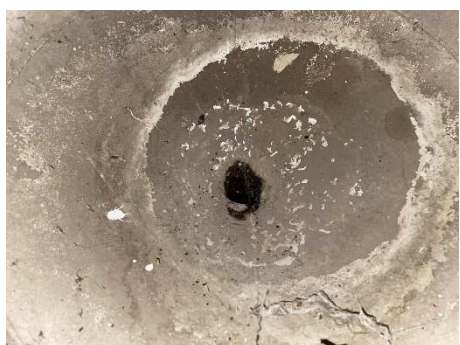
Vervuilde ondersectie CLV-kanaal
