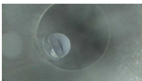
Binnenzijde RGA-kanaal, aansluiting ketel
