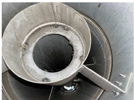
Open onderzijde RGA-kanaal
