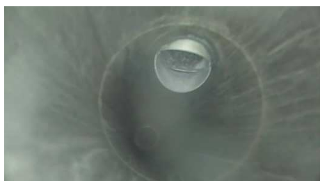
Binnenzijde RGA-kanaal, aansluiting ketel
