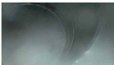
Binnenzijde inspectievoorziening CLV-kanaal
