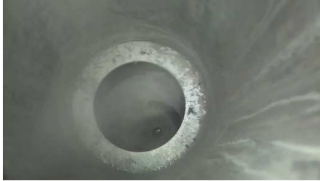
Open ondereinde rookgasafvoerkanaal
