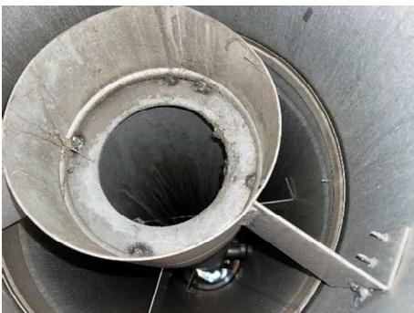
Open onderzijde RGA-kanaal
