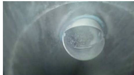
Licht verontreinigde aansluiting ketel
