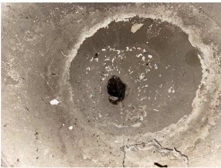
Vervuilde ondersectie CLV-kanaal
