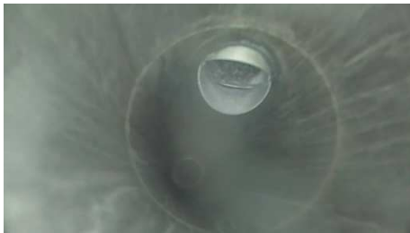
Binnenzijde RGA-kanaal, aansluiting ketel
