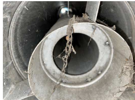
Open onderzijde RGA-kanaal
