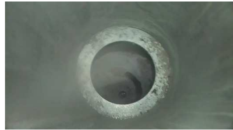
Open ondereinde rookgasafvoerkanaal
