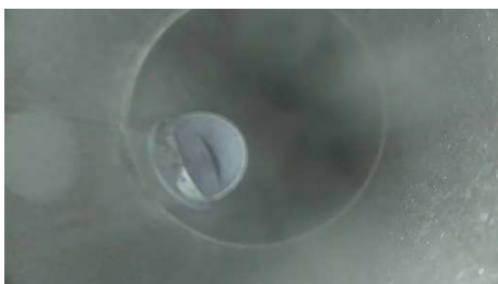
Binnenzijde RGA-kanaal, aansluiting ketel
