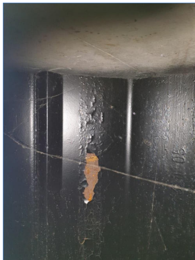
Put 1, afbladdering coating, bovenzijde damwand.
