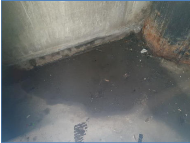
Put 1, hoek bij betonwand. Corrosie tot circa 20 cm hoogte.
