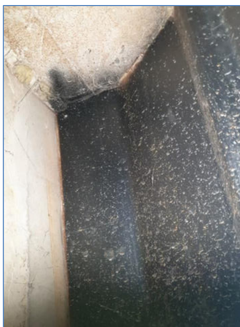
Put 2, damwand aan bovenzijde wand. Duidelijk zichtbaar coating met spuitbus aangebracht.
