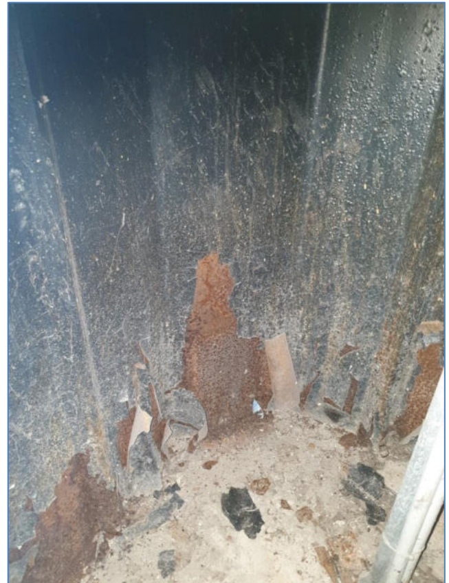
Put 2, detailopname bij vloer, coating bladdert af. Onder de coating egale roestvorming.
