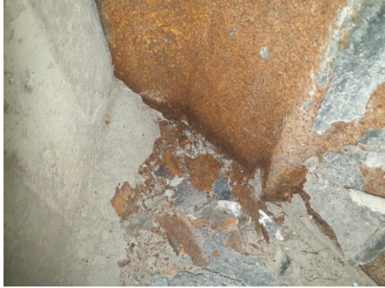
Put 2, detailopname, egaal gecorrodeerd onder de coating.
