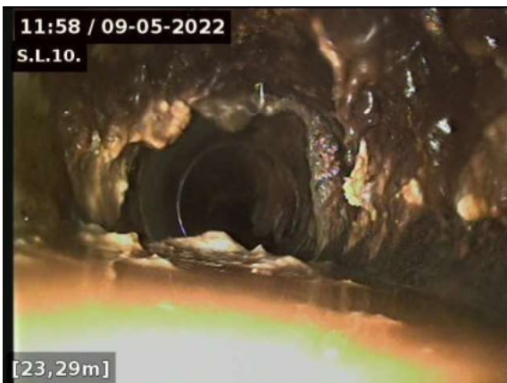
Vervuiling liggende leiding SL 10.
