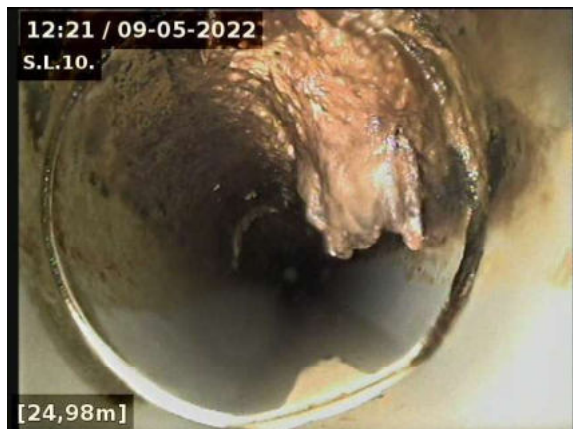
Vervuiling liggende leiding SL 10.
