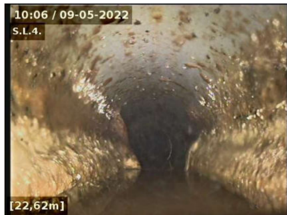
Vervuiling liggende leiding SL 4
