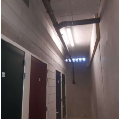
Leidingwerk zichtbaar op -1
