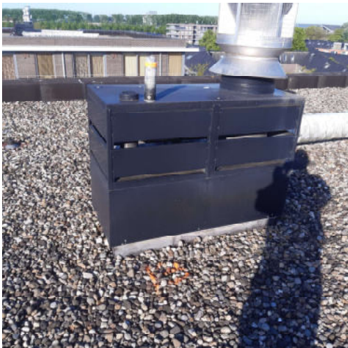
Beluchtingen op het dak/kast.
