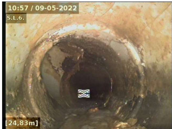
Vervuiling liggende leiding SL 6.
