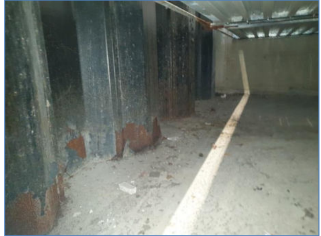
Put 1, corrosie vooral boven de vloerlijn tot circa 30 cm hoogte duidelijk zichtbaar.
