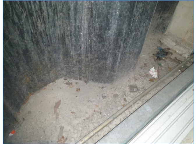
Put 2, detailopname, zwarte coating met spuitbus Aangebracht. Corrosie onder de zwarte coating.
