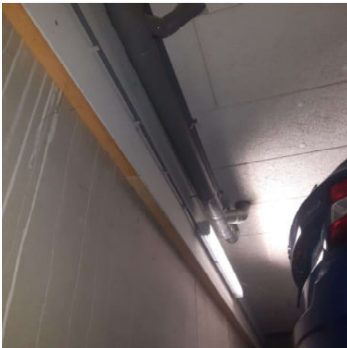
Leidingwerk zichtbaar op -1
