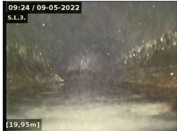
Vervuiling liggende leiding SL 3
