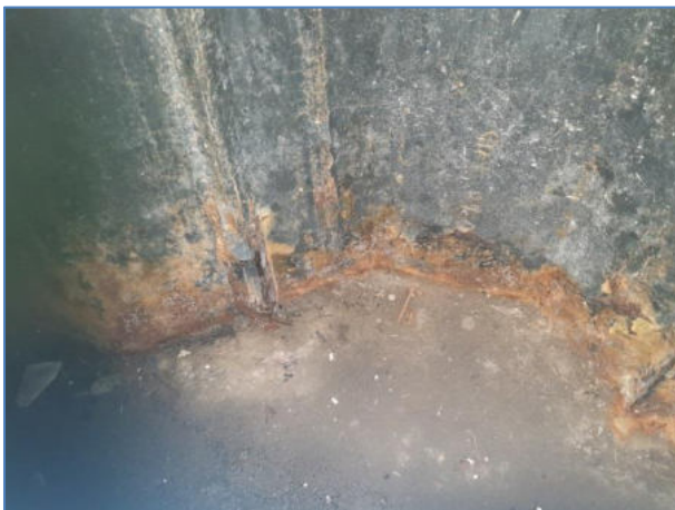
Put 1, corrosie tot circa 20 cm hoogte.
