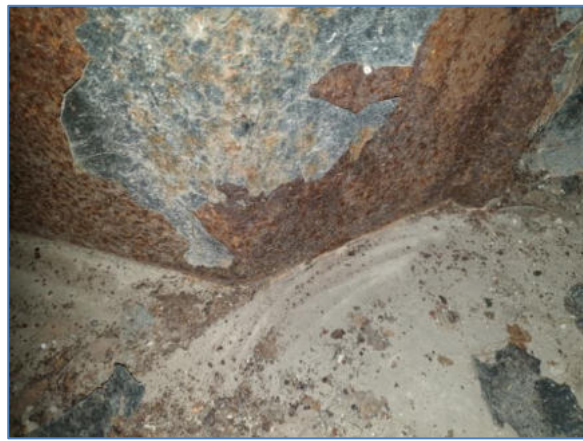
Put 2, detailopname, egaal gecorrodeerd onder de coating.
