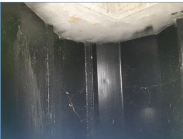
Zwarte coating met spuitbus aangebracht. Zie ook de coating op de betonnen balkconstructie aan de bovenzijde van de damwand.
