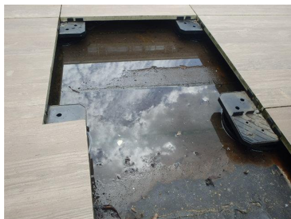
4: plaatselijk aanwezige plasjes
