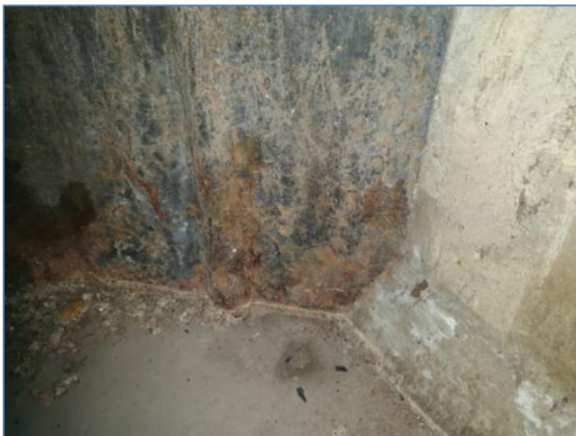
Put 2, detailopname corrosie tot circa 20 cm boven de vloer.
