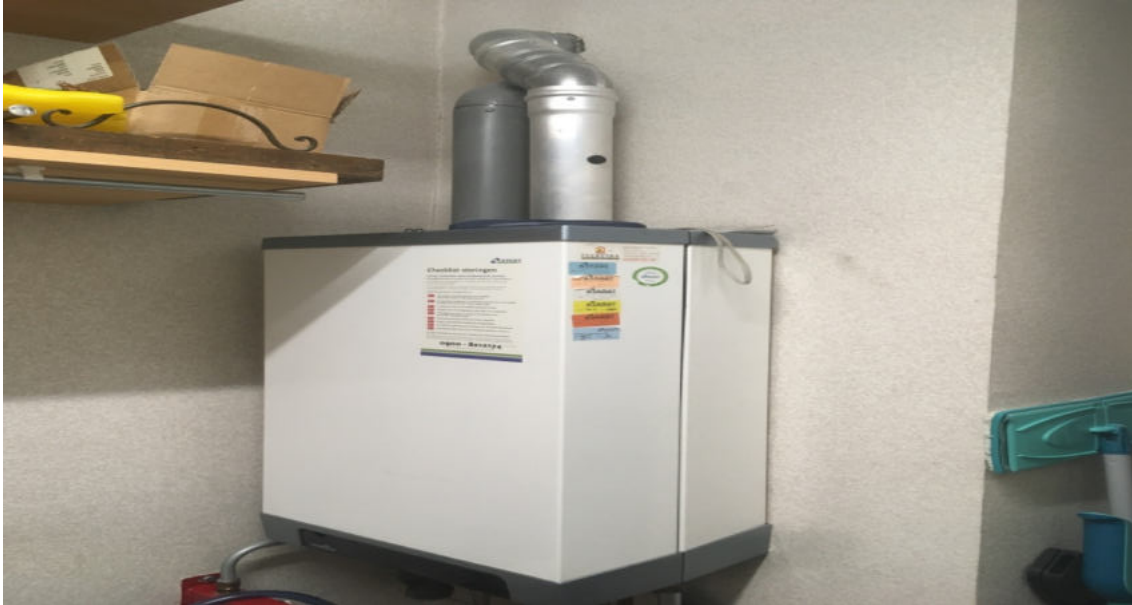
Afb.8 Situatie in één van de woningen; de rookgasafvoer en luchttoevoer zijn niet gebeugeld conform de eis zoals deze in de rogafa gesteld wordt ( www.rogafa.nl ) Verder zijn er geen brandmanchetten aanwezig bij de doorvoer van de rookgasafvoer en luchttoevoer vanuit de woning naar de bouwkundige schacht. Tevens zijn in deze woning de rookgasafvoer en de luchttoevoer geschroefd. Dit is niet toegestaan.
