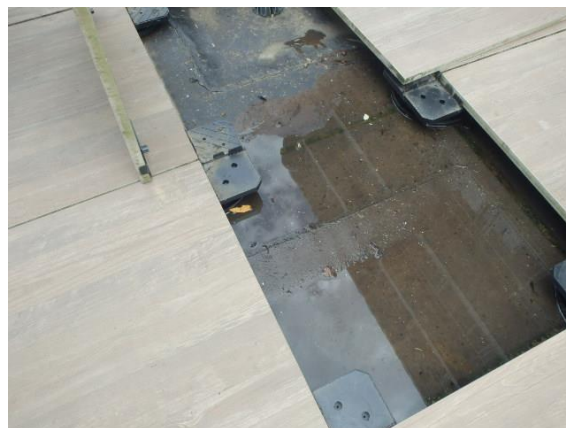
2: plaatselijk aanwezige plasjes
