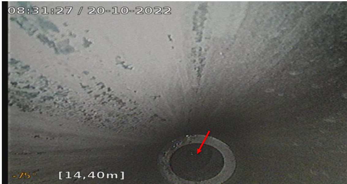
Afb.4 CLV-kanaal; dit betreft de bodemsectie; geen ophoping van condensaat waarneembaar in deze strang. Tevens is hier goed zichtbaar dat de bodemsectie aan de onderzijde open is wat aangeeft dat het hier een onderdrukstelsel betreft (rode pijl)
