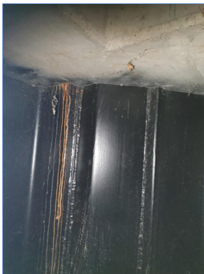
Put 1, roestvorming aan bovenzijde damwand, vanwege geringe lekkage.
