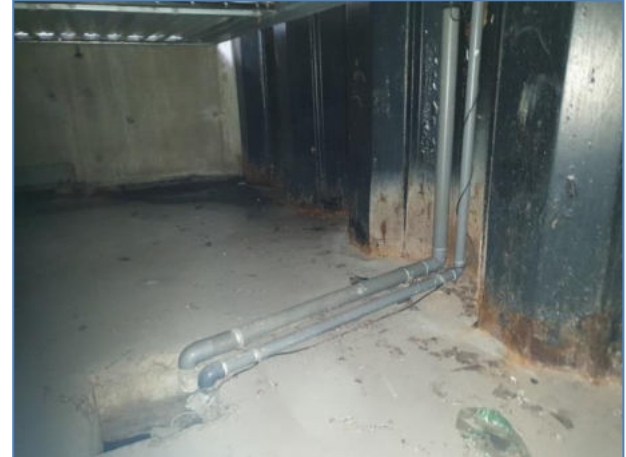
Put 1, corrosie vooral boven de vloerlijn tot circa 30 cm hoogte.
