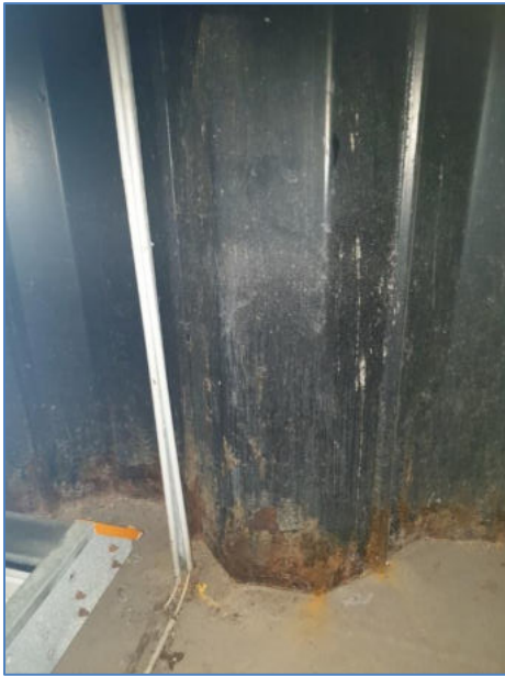
Put 2, onderzijde damwand corrosie tot circa 20 cm boven de vloer.
