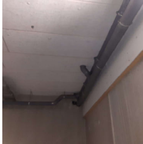
Leidingwerk zichtbaar op -1
