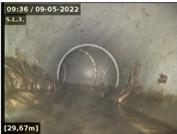
Vervuiling liggende leiding SL 3
