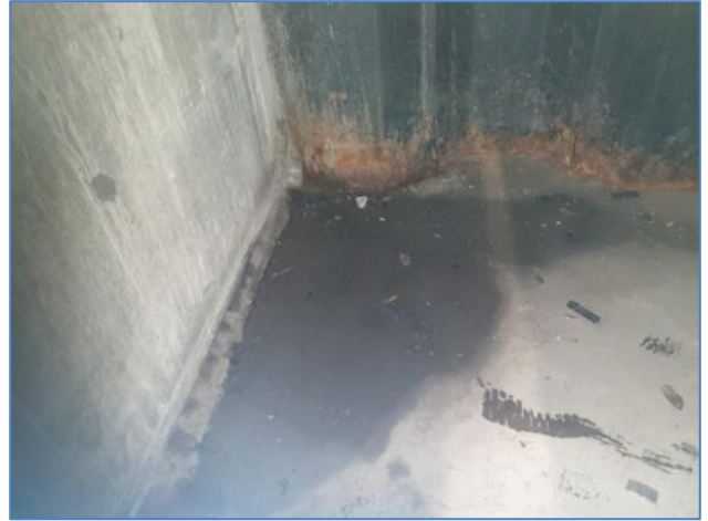
Put 1, hoek met natte plek. Waarschijnlijk lekwater dat naar de hoek van de put loopt vanwege tegenschot in de vloer.
